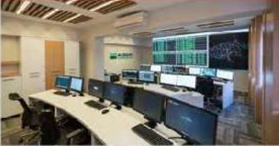
CLK Antalya-Sivas-Bursa Scada Merkezleri
